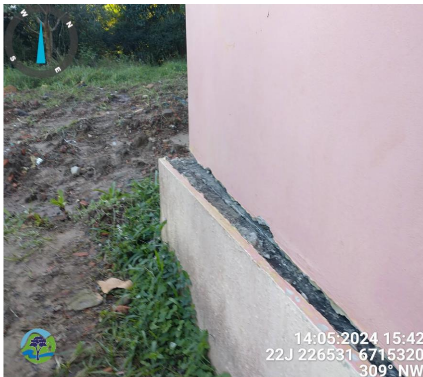
Figura 7 - Deslocamento horizontal da viga baldrame,
