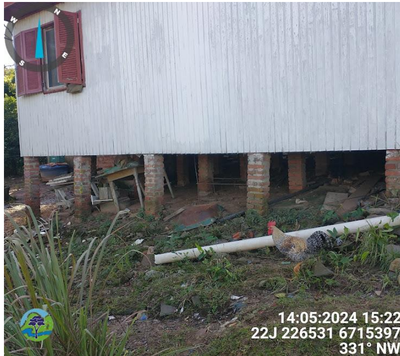
Figura 4 - Casa localizada na região da crista do escorregamento, com pilares inclinados devido à movimentação do solo.
