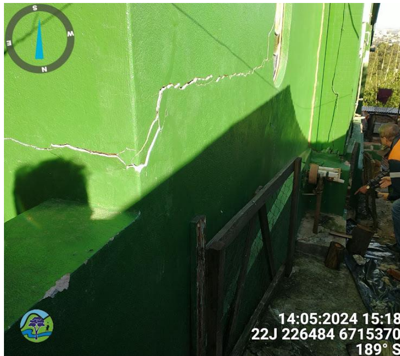
Figura 5 - Casa localizada mais danificada, com diversos danos estruturais e relatos de barulhos na estrutura no dia da vistoria.
